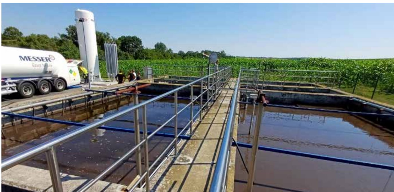
Dvojice aktivačních nádrží při vypnutém provzdušňování. Na modrých nosičích jsou zavěšeny kyslíkové rošty. V pozadí je zásobník a odpařovač kapalného kyslíku
