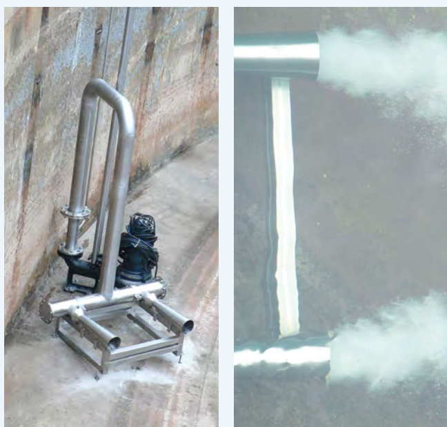
Obr. 1 Instalace malého kyslíkového injektoru o kapacitě 25 kg/h O_2 . Detail trysek injektoru v chodu při zkouškách s říční vodou
